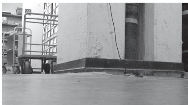
Archivgut ist schwer und verursachte diese massive Absenkung der Bodenplatte. Vermeidbarer Bauschaden durch die Nutzung ungeeigneter Räume als Archivmagazine.
